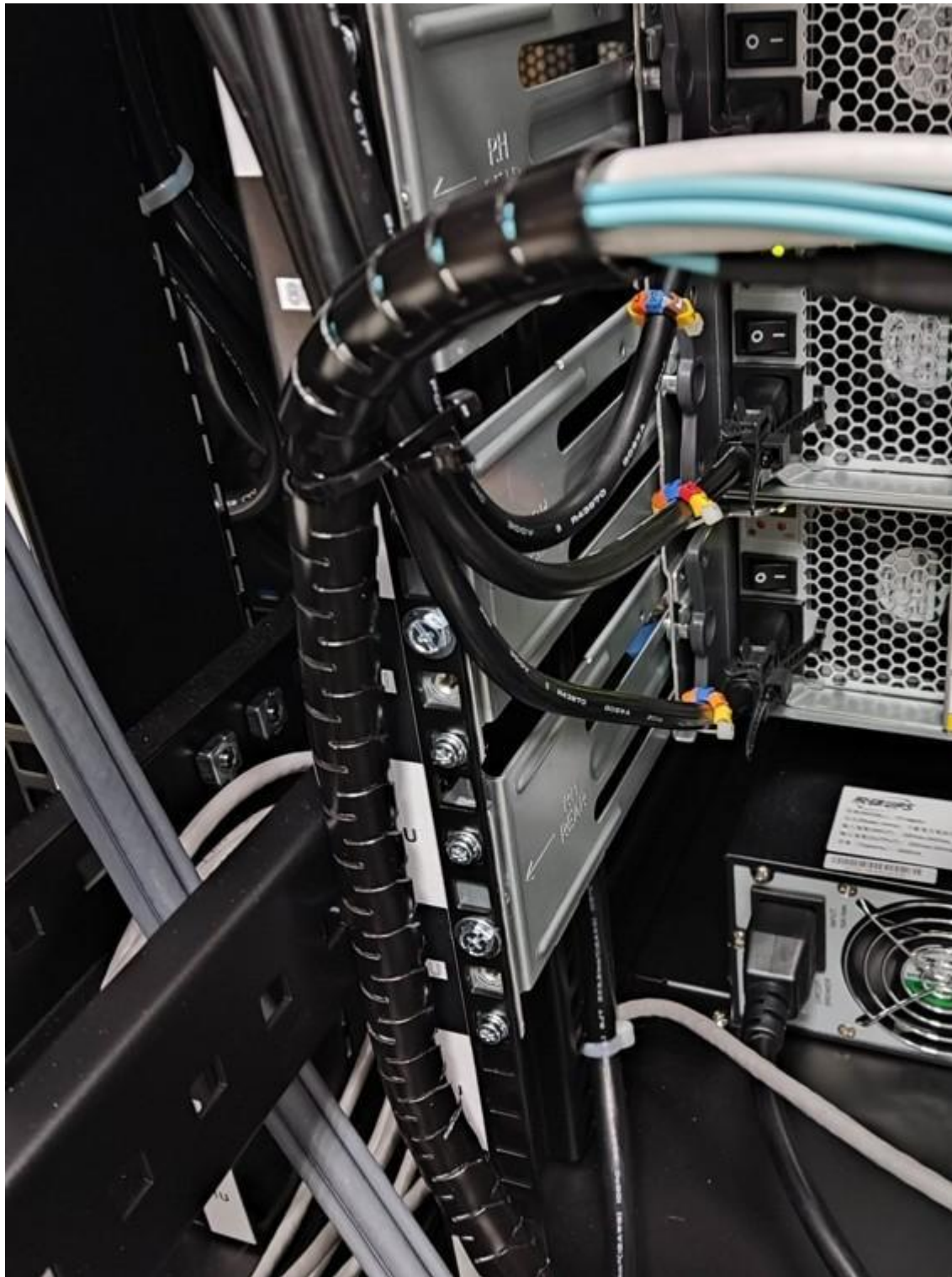
線路整理與標籤樣態
