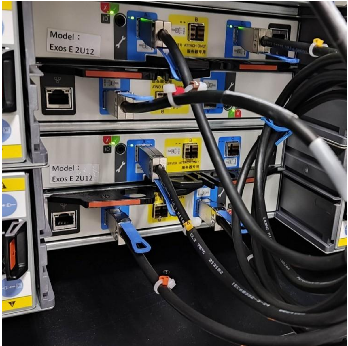
線路整理與標籤樣態
